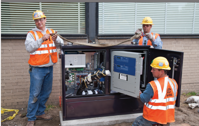
Instalación de un Seccionador de Distribución Subterránea Vista de Super- visión Remota de S&C para el Sistema Ultrarrápido de Despeje de Fallas.
